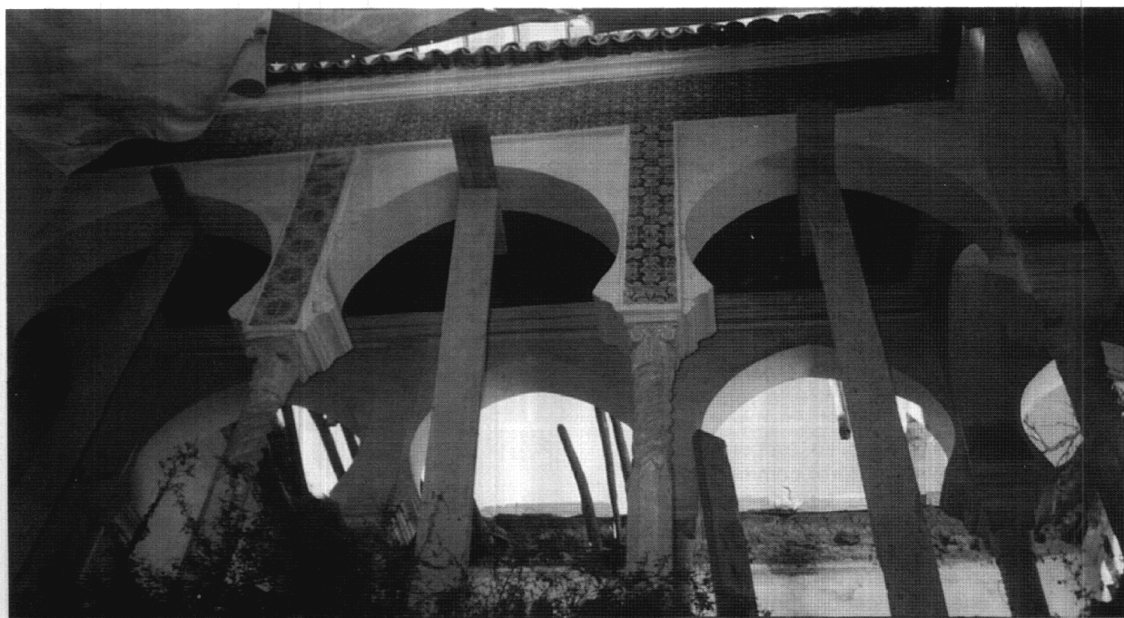
LE PATIO DÉMANTELÉ PAR LES EFFONDEMENTS.
